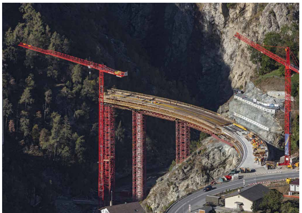
Die abgetragene und gesicherte Felsnase, die Hilfsbrücke unten im schwer zugänglichen «Chi», Brückenbau zweite Etappe
