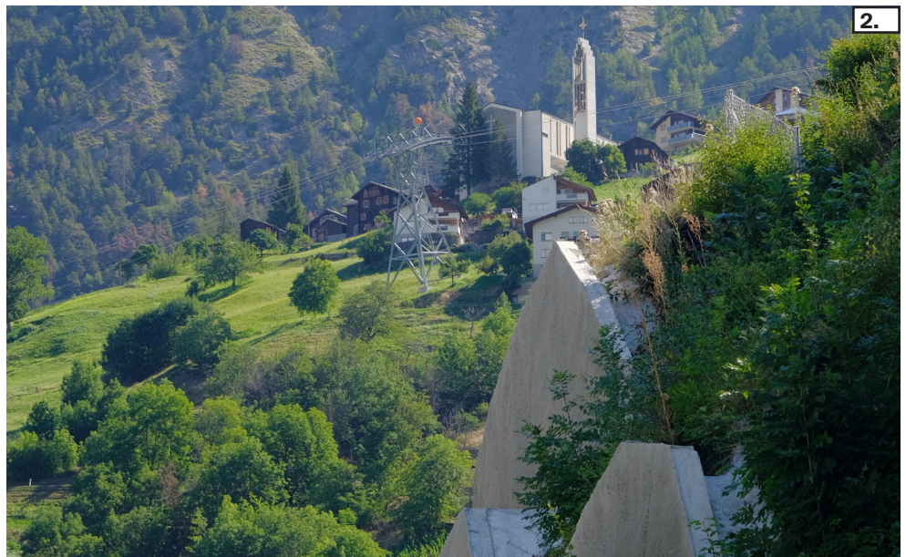
Die Natur erobert sich ihr Terrain zurück: Hanganschnitt «Mischabel»: 136 m lang, 28 m hoch.
